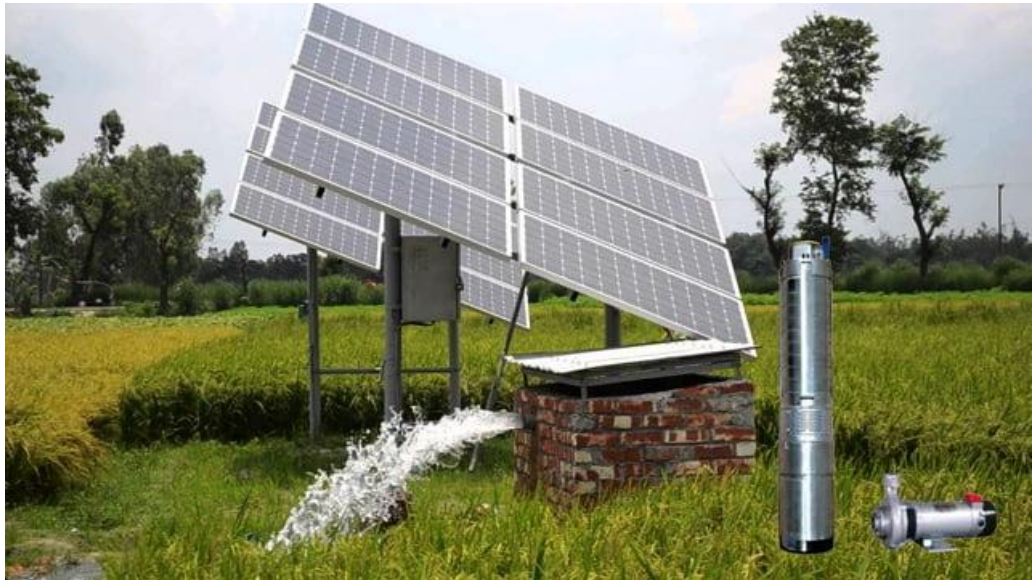
Gambar 3. Instalasi Sistem Energi Surya untuk Irigasi
