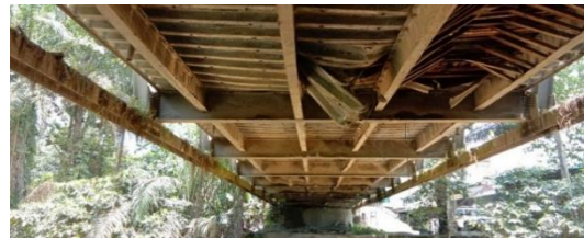
Gambar 5. Kondisi Lantai Jembatan Aek Parlampungan
