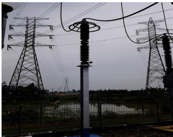
Gambar 4. Lightning Arrester di sisi masuk gardu induk Tanjung Morawa
