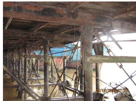
Gambar 4. Rangka Penyangga Terkorosi Uap Air Laut
