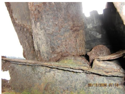
Gambar 3. Tiang Penyangga Terkorosi Uap Air Laut
