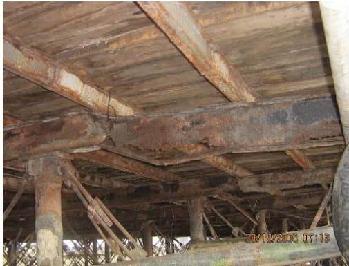
Gambar 2. Lantai Besi Terkorosi Uap Air Laut
