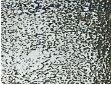
Gambar 10. Scanning Baja Karbon Rendah.Dikorosi
