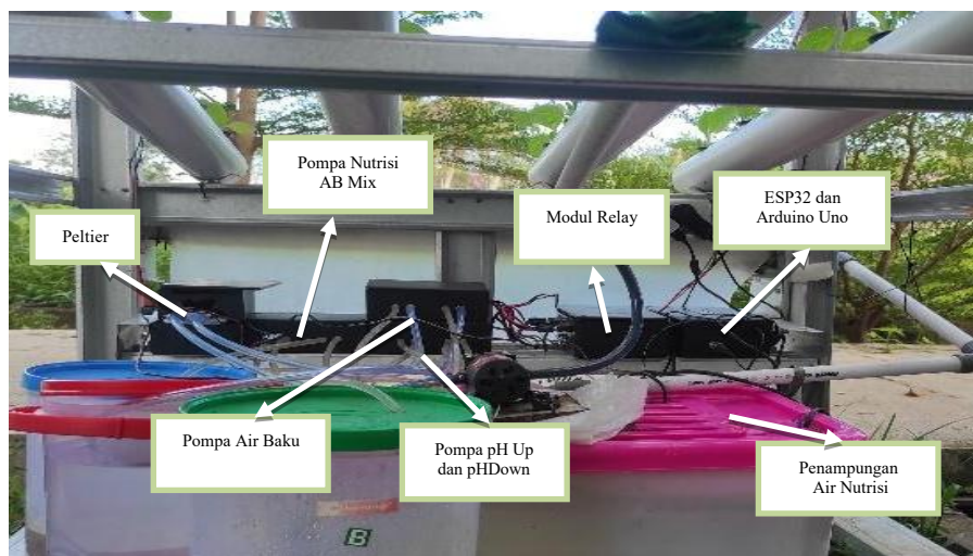
Gambar 4. Implementasi keseluruhan sistem pada instalasi hidroponik
