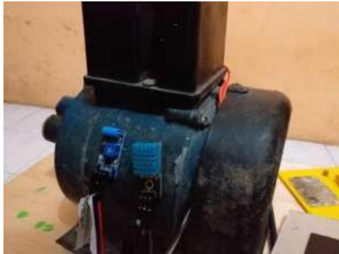
Gambar 7. Pemasangan Sensor DHT11
