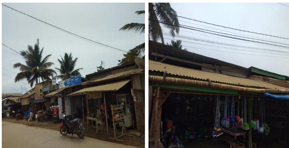
Gambar 1. Kondisi Seng/Atap di Desa Morosi (kiri) dan Desa Puuruy (kanan)
